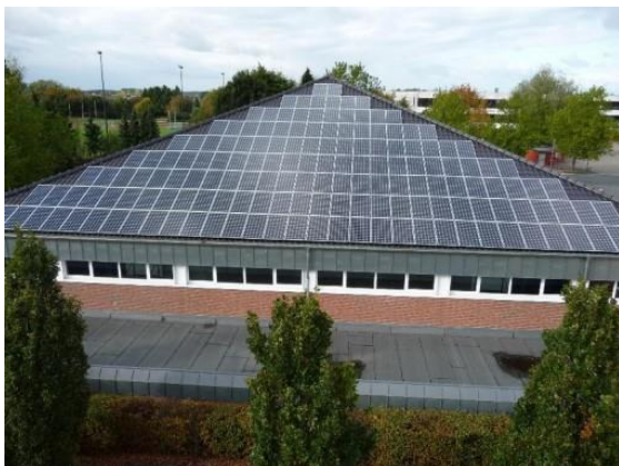
Photovoltaikanlage auf der Zweifach-Sporthalle, Kevelaer
