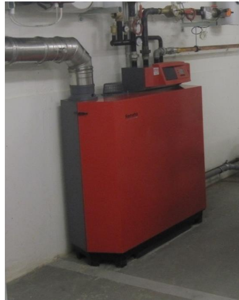
Erdgas-Brennwertkessel im Rathaus, Wallfahrtsstadt Kevelaer
