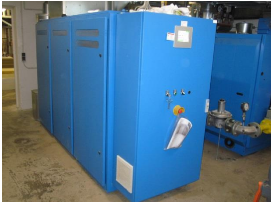
BHKW im Hallenbad, Wallfahrtsstadt Kevelaer
